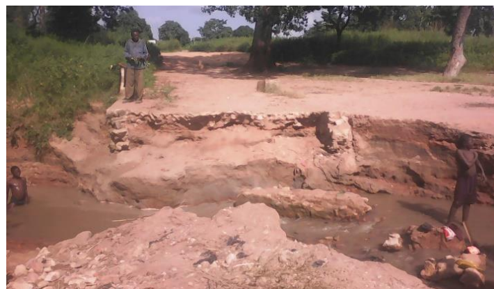
Crédit: UNHCR. Danamadja, Logone Oriental. L'état de dégradation avancée du radier situé entre le site de Danamadja et le village Kobiteye
