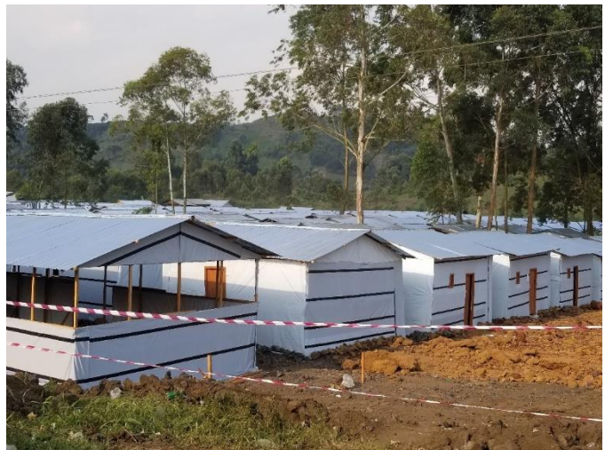
Les travaux de construction se poursuivent dans le site qui va accueillir les populations sinistrées. OCHA/Gustave Ngandu
