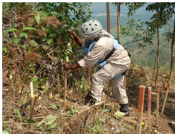
Avancée par couloirs du travail de déminage, à Rugazi, province de Bubanza
