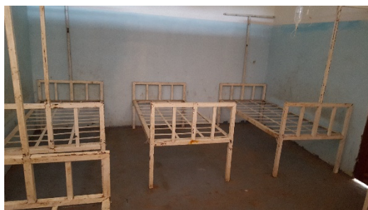
Etat du Centre de Santé Kabeya Lumbu (Province du Kasai) après les affrontements entre la milice et l'armée en début 2017. ©OCHA/J. Mankamba
