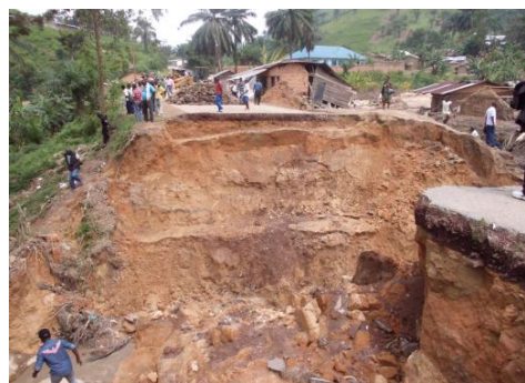
Rupture de la route à Kichanga
