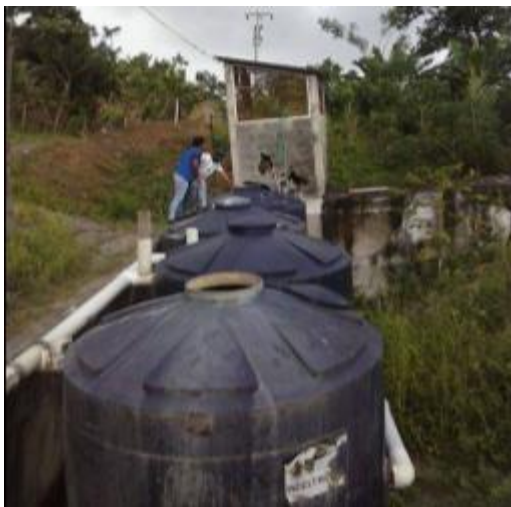
Tanques de almacenamiento de agua potable para distribución en Viche.
