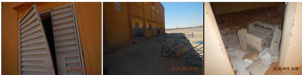
De gauche à droite : Porte d'une salle de classe endommagée de l'école maternelle (Ménaka), tables et matériels didactiques du lycée de Ménaka endommagés
