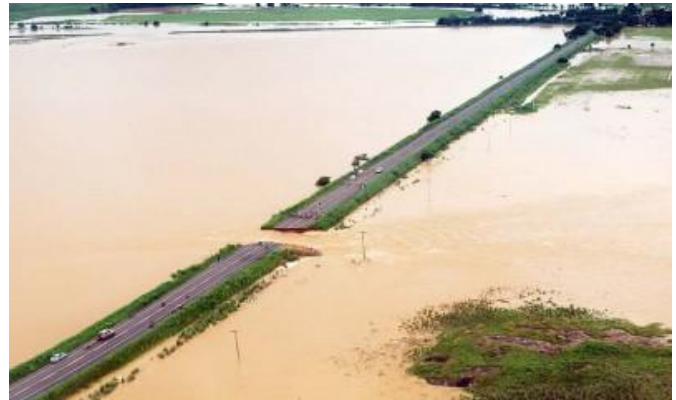
La carretera que funciona como dique en el río Muriaé (Minas Gerais) colapsó durante las inundaciones. © (EFE).
